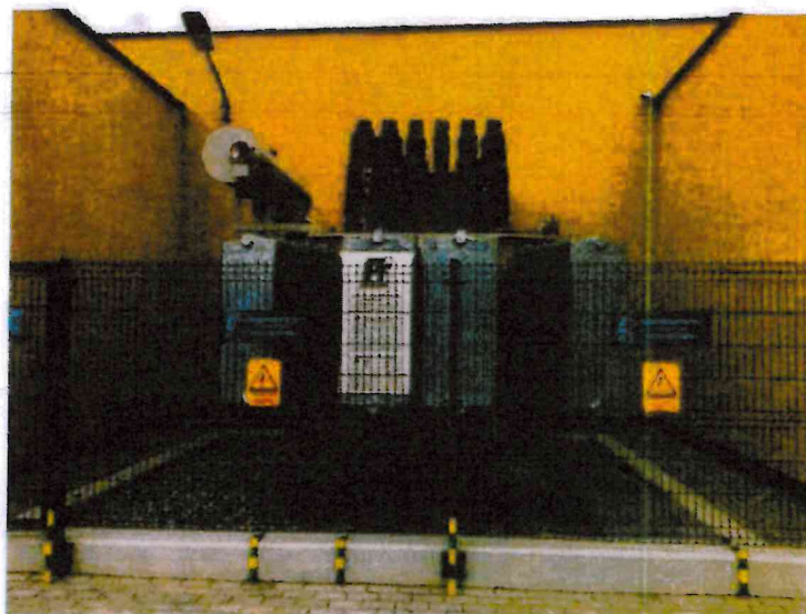
Zal. nr 2: Widok ogólny transformatora prostownikowego TPr1
