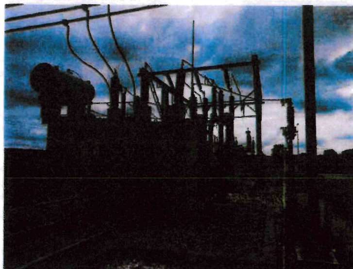
Zal. nr 2: Widok ogólny transformatora TR1
