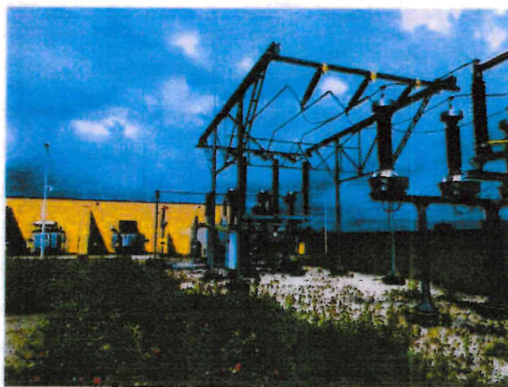
Zal. nr 1: Widok ogólny stacji elektroenergetycznej.
