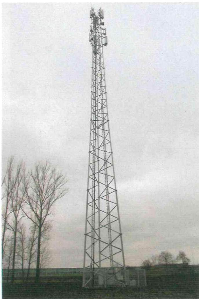
Zał. nr 1: Widok ogólny instalacji radiokomunikacyjnej.
